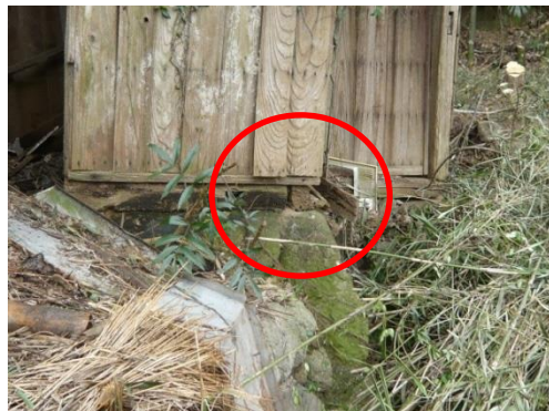
土台が腐朽して欠損している
