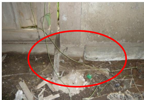
基礎、土台がずれている
