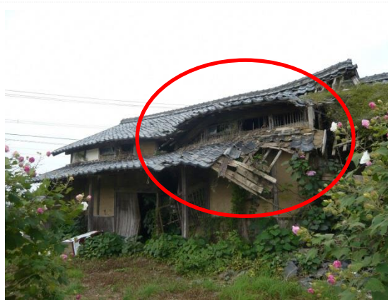
屋根が一部落下している
