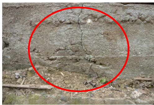
基礎にひび割れが発生している
