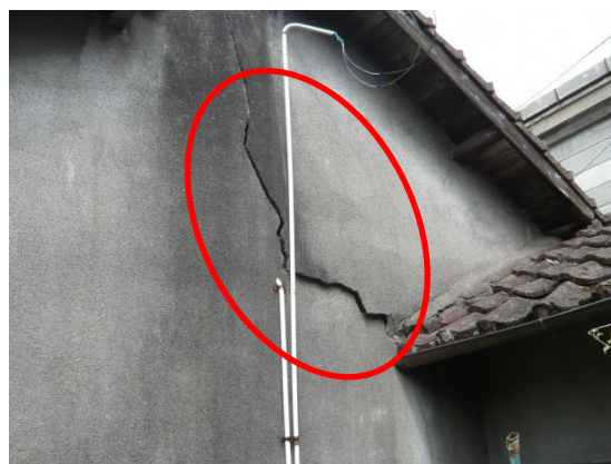
外装材にひび割れがある
