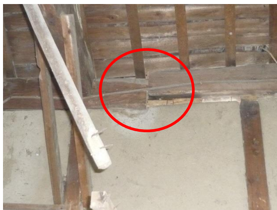
梁の接合部がずれている
