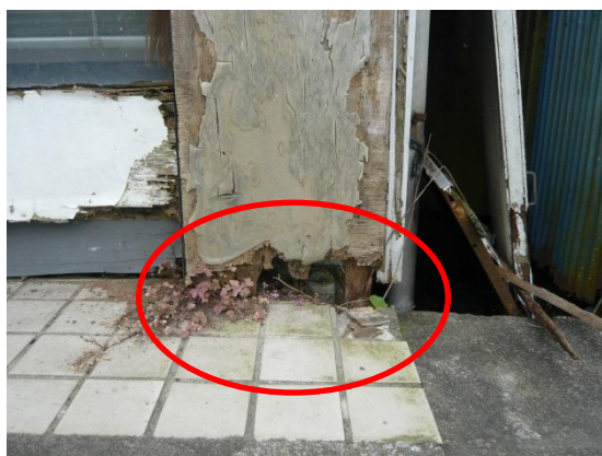
柱脚が腐朽し欠損している
