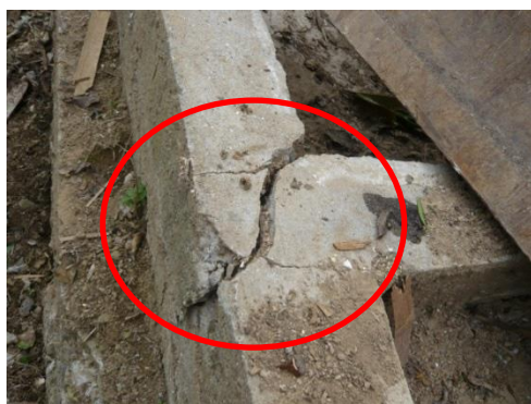
基礎がひび割れ、土台が無い
