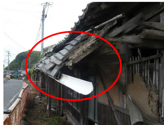
屋根、軒が垂れ下がっている
