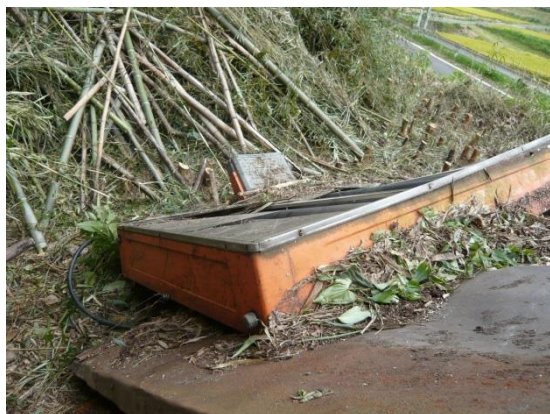
屋上給湯設備の落下
