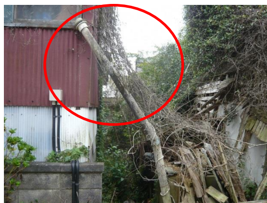
臭気筒が隣地へ倒れている
