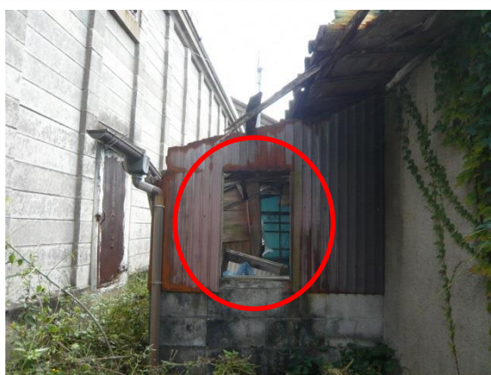
門扉がなく侵入できる
