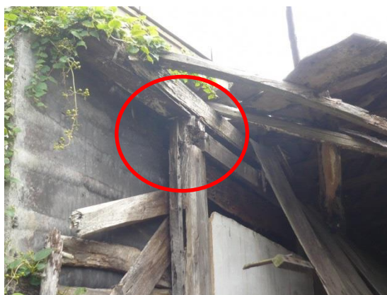
梁の腐食により欠損している
