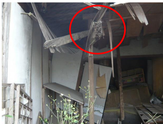
柱、梁が破損している
