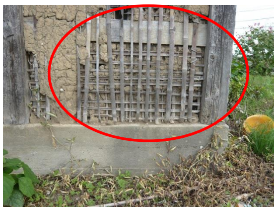
外壁材が剥がれて土壁が露出
