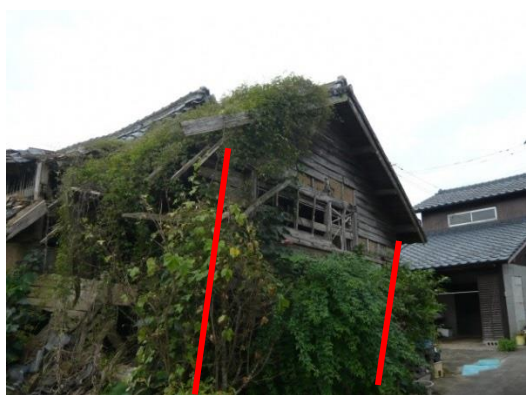
建物が傾斜し、道路に倒壊の危険
