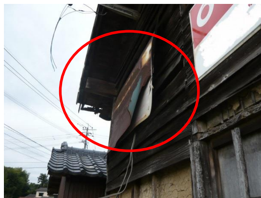
鉄製看板の落下の危険性
