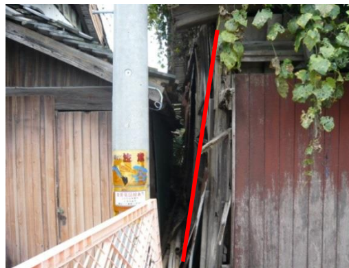
柱が傾斜している
