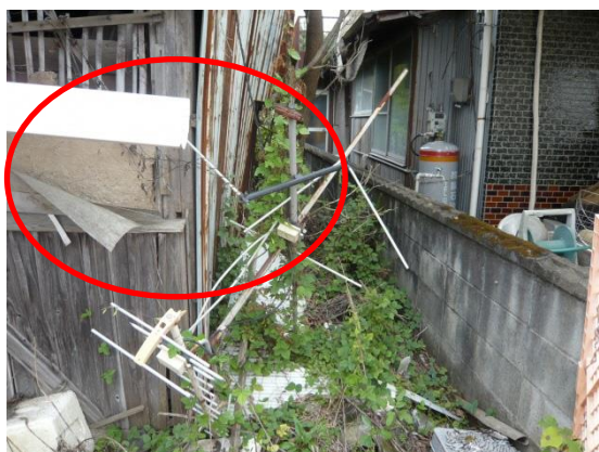
外壁材が剥がれている
