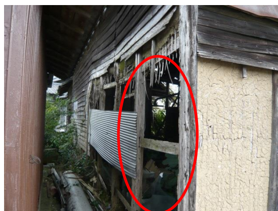
外壁材が無くなっている
