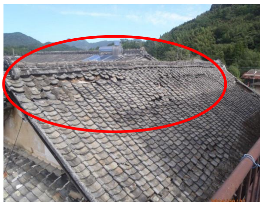
瓦が周囲に飛散する危険がある
