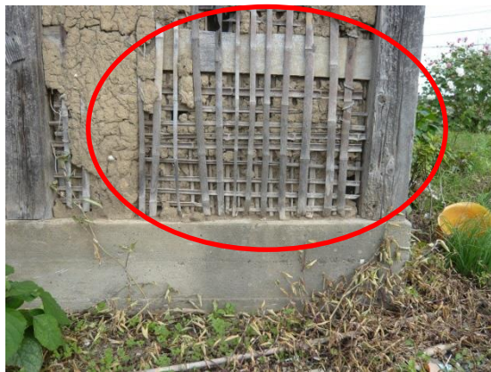
外壁材が剥がれて土壁が露出
