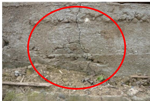
基礎にひび割れが発生している
