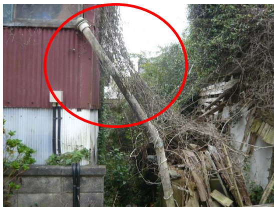
臭気筒が隣地へ倒れている
