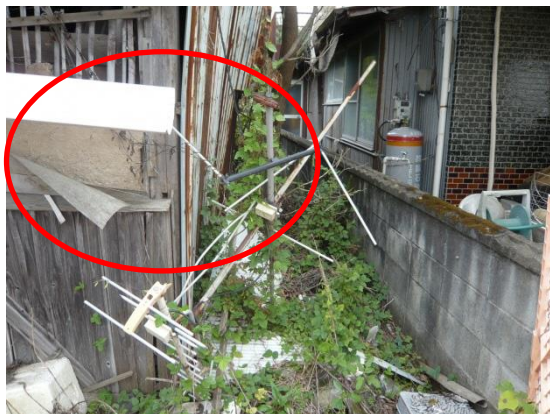
外壁材が剥がれている
