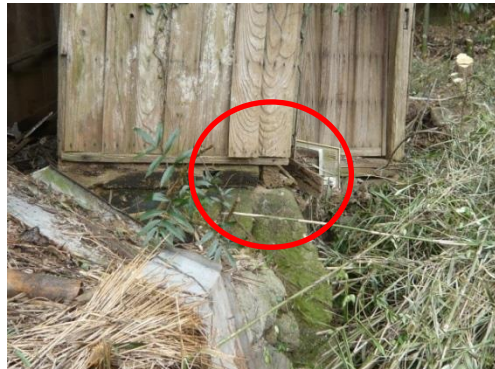
土台が腐朽して欠損している
