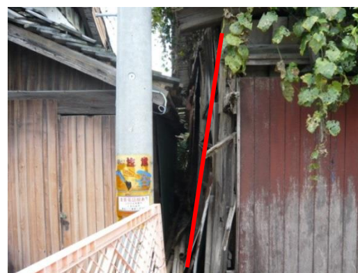
柱が傾斜している
