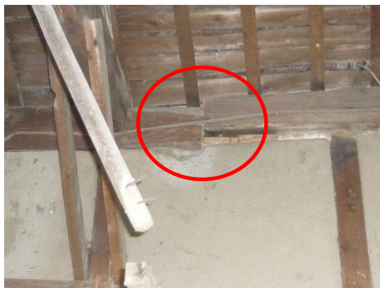
梁の接合部がずれている
