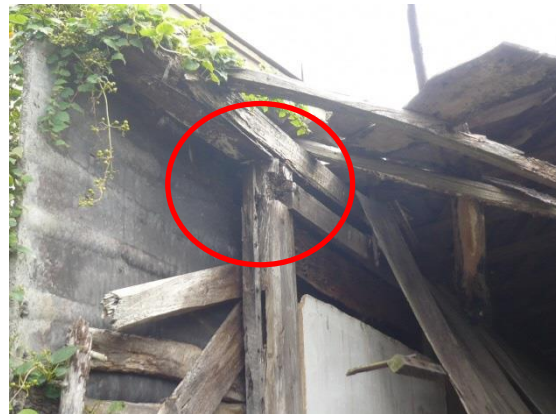
梁の腐食により欠損している
