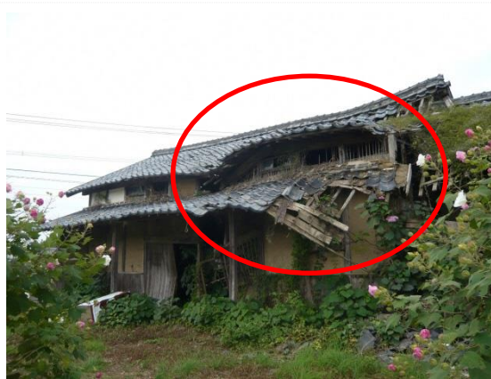
屋根が一部落下している
