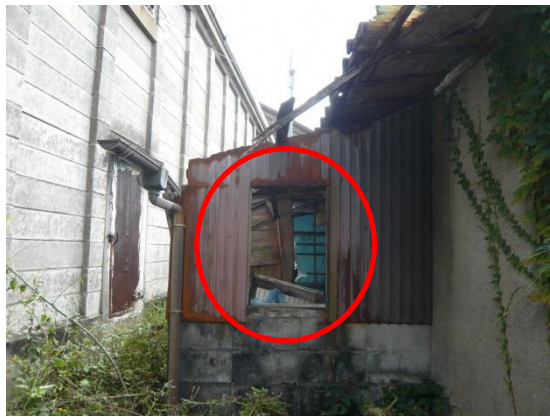
門扉がなく侵入できる
