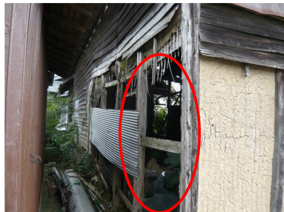
外壁材が無くなっている
