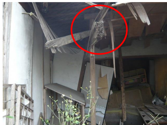
柱、梁が破損している
