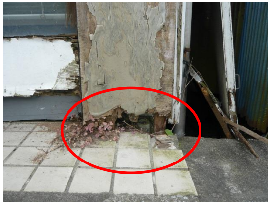
柱脚が腐朽し欠損している
