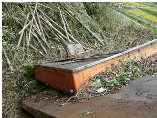
屋上給湯設備の落下
