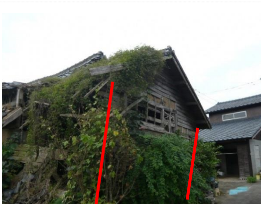
建物が傾斜し、道路に倒壊の危険
