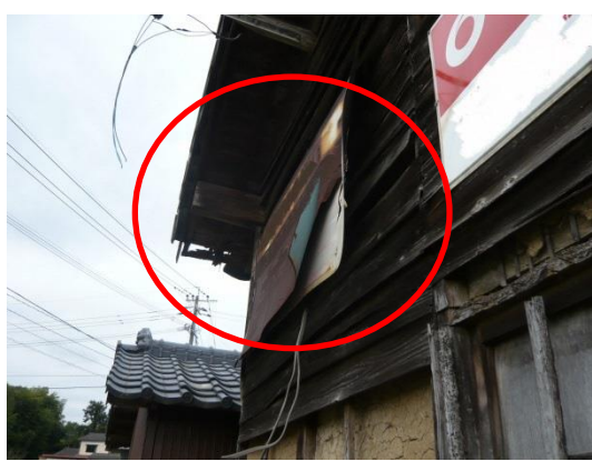
鉄製看板の落下の危険性
