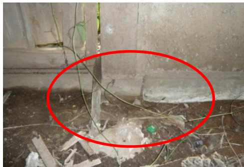
基礎、土台がずれている
