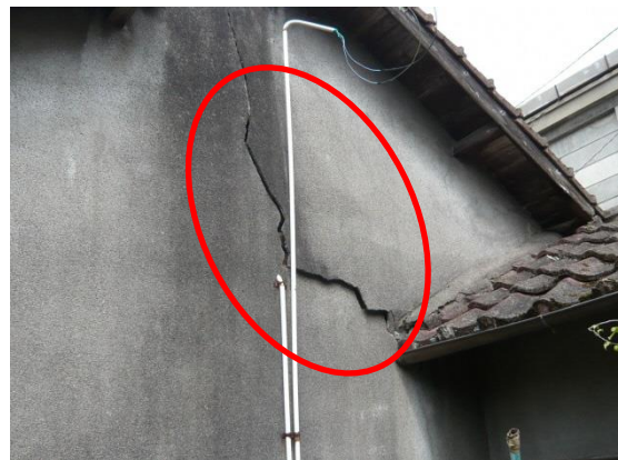
外装材にひび割れがある
