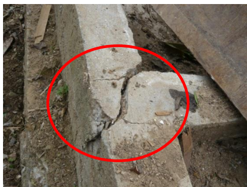
基礎がひび割れ、土台が無い
