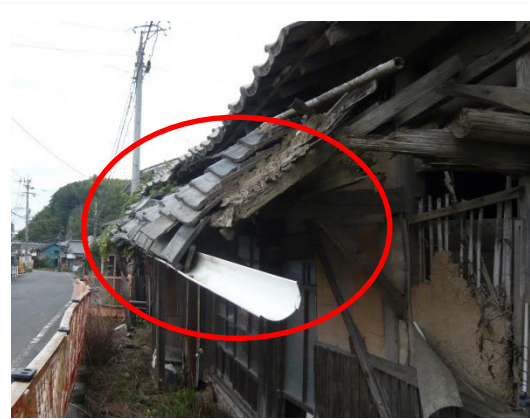
屋根、軒が垂れ下がっている
