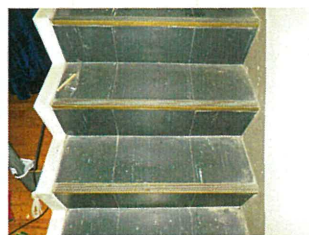
階段床 13-1 ビニル床タイル
