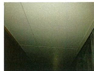
天井 15-1 石膏ボード
