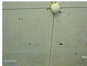
天井 15-1 石膏ボード
