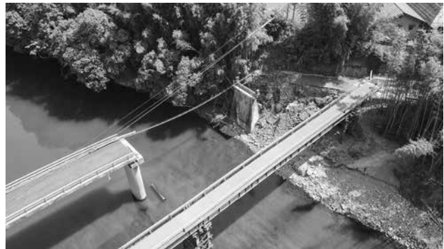
令和2年7月豪雨災害復旧事業 下泊里人道橋(仮橋)設置工事
